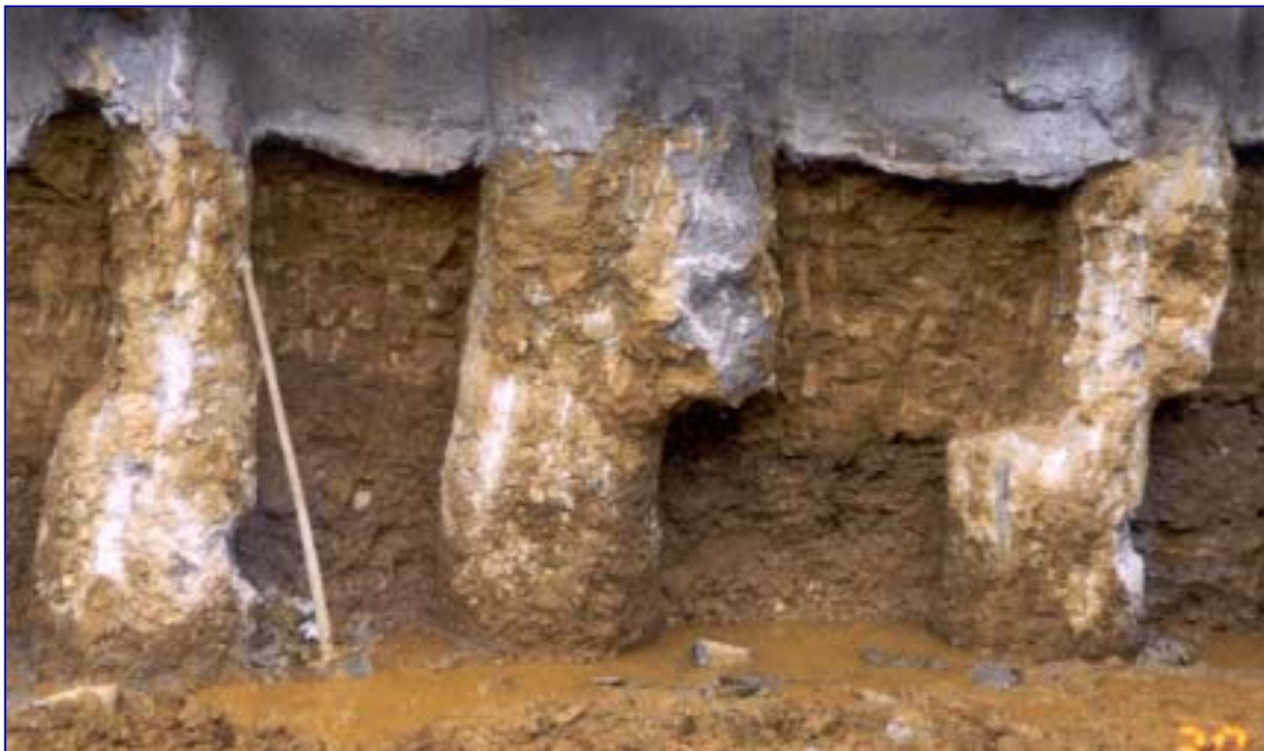
Bild 2: Schäden an Schneckenbohrpfählen im weichen Boden
